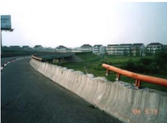
锚固钢板被拔出
